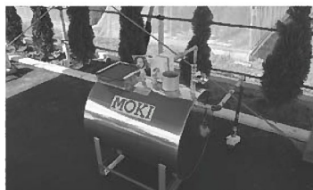
観光拠点施設に設置した竹ボイラー設備
