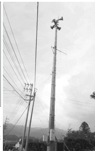
小園地区の防災行政無線の子局受信アンテナと拡声器
