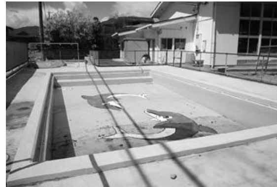
安全対策処置待ちの南保育園プール
