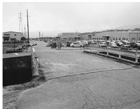
一日も早い国の交付金が望まれる筏橋の整備
