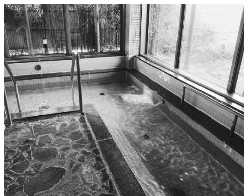
利用者の多い「憩の家」の浴場、補修で乗り切れるか
