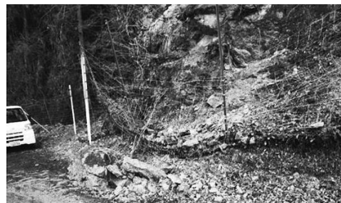
落石によって破損した防護柵
