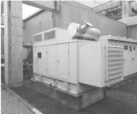
地上3mに設置が求められている非常用電源
