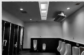
道の駅トイレにエアコンを
